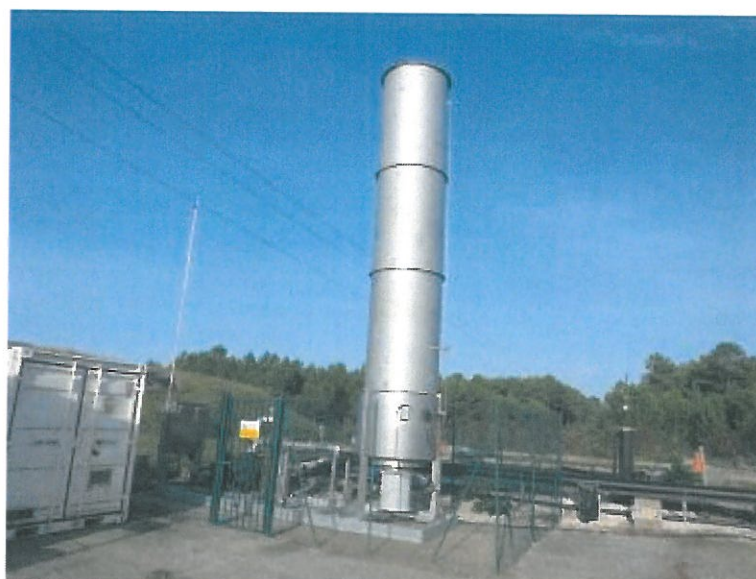
Figure 12 : Photographie Nouvelle Torchère 1000 Nm 3 /h
