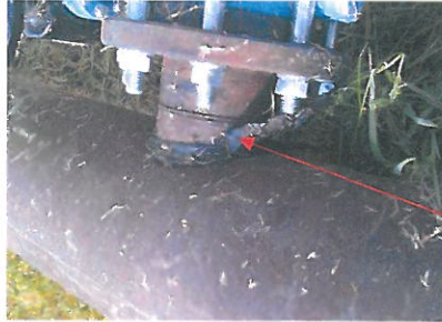
Illustration N°7 Prise d'air sur soudure au puits 204 au niveau du raccord 200/110
