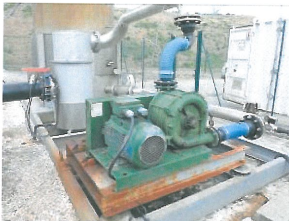
Figure 14 : Installation surpresseur 600m 3
